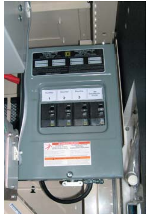
Fig. 3-6, Enclosure Breaker Box
